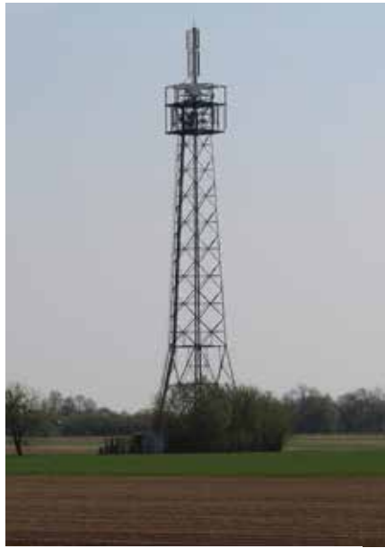
Mobilfunkmast (D 1) nördlich von Kirchroth 2018
