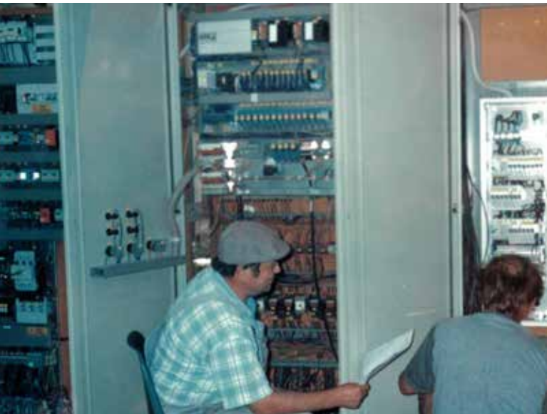
Schaltraum der Kläranlage 1999
