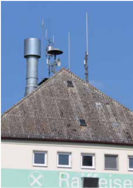
Mobilfunkanlage (D2) Pondorf 2018
